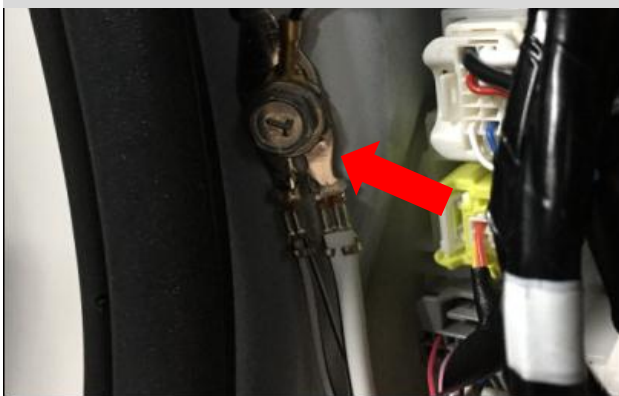
接负极在 A 柱位置松动螺母不用拆下，卡进负极连接片，卡紧后再还原拧紧螺母，用于连接我们的黑色负极，固定好；(箭头)
